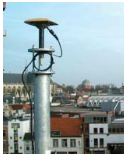
Fig 2. Antenne met mast van NETPOS.
